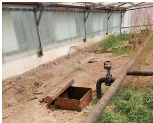
地埋式生化处理设施
