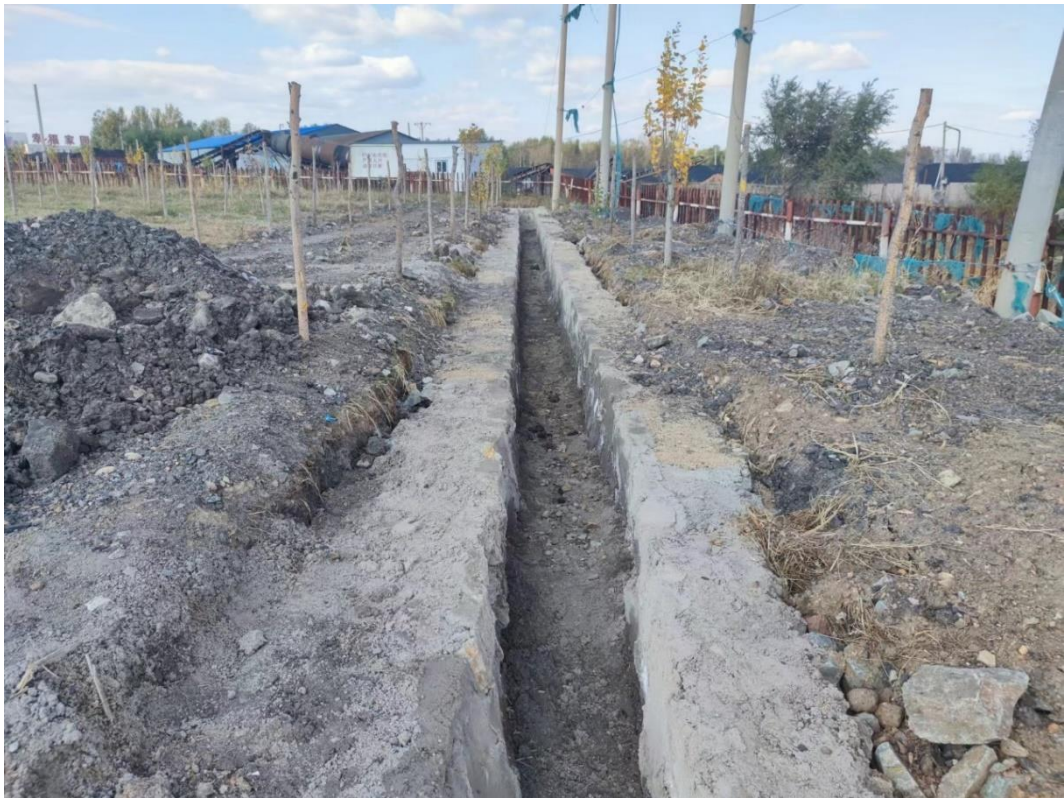
排矸场排水沟
