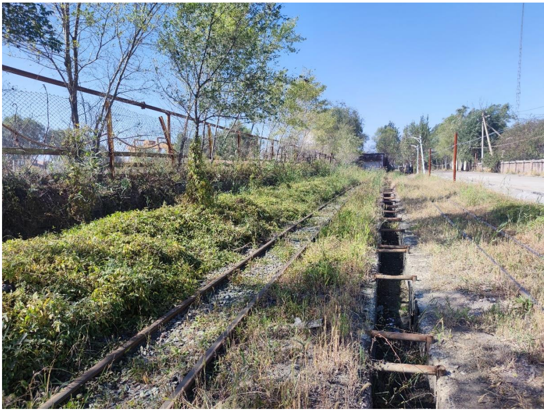
工业场区排水沟
